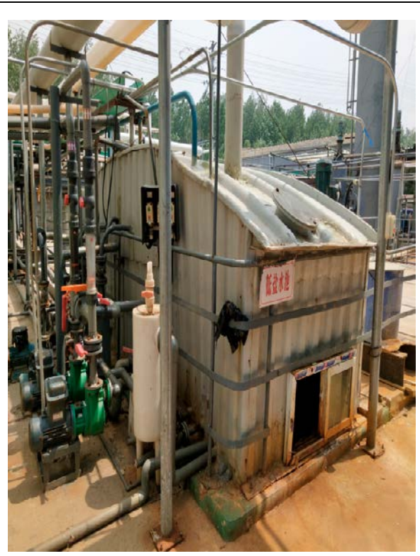
低盐废水收集池
