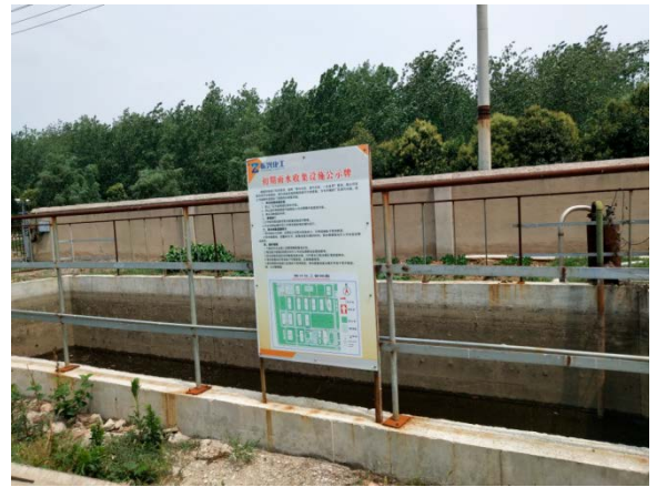
初期雨水收集池
