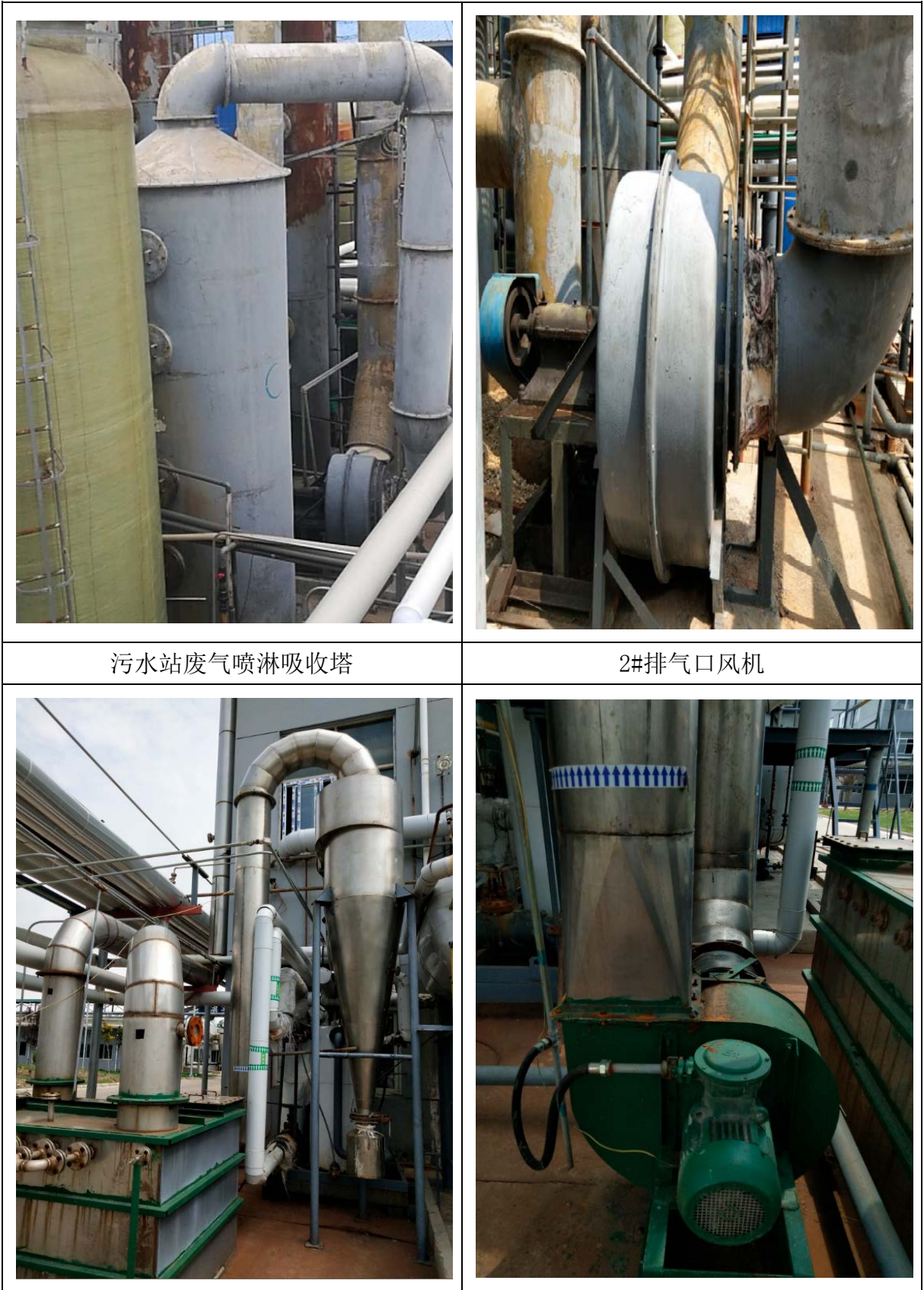
图 4.1-4 废气主要治理设施
